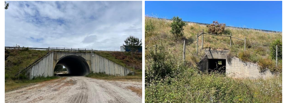
Passagem agrícola e passagem hidráulica na A2 (da esquerda para a direita).
